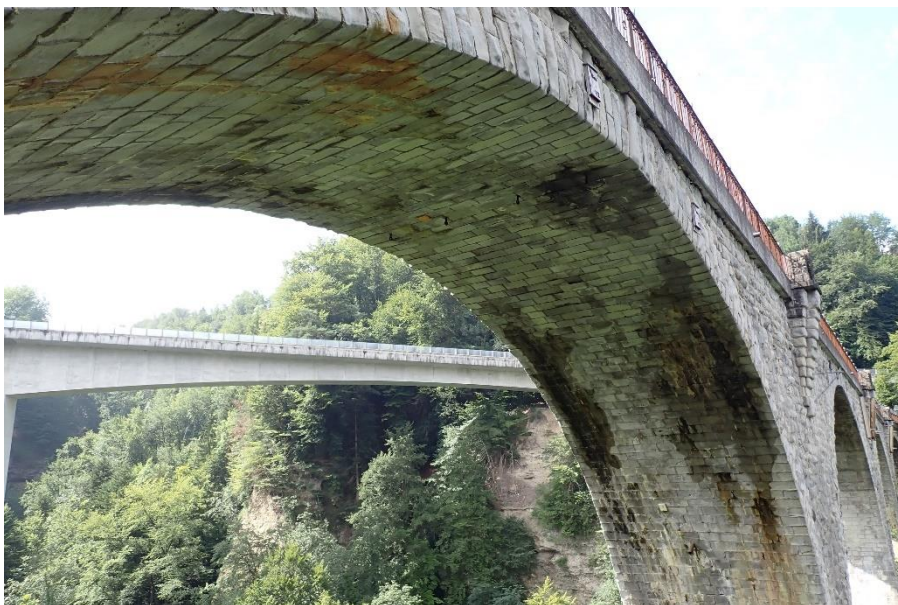
Abb. 1: Durchnässte, schadhafte Gewölbeuntersicht
