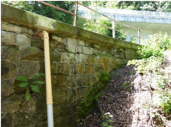
Abb. 2: Schadhafte Flügelmauer mit prov. Entwässerung beim Widerlager Seite Zug
