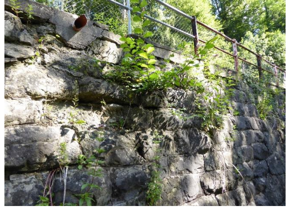
Abb. 6: schadhafte, hohe Flügelmauer Seite Ägeri
