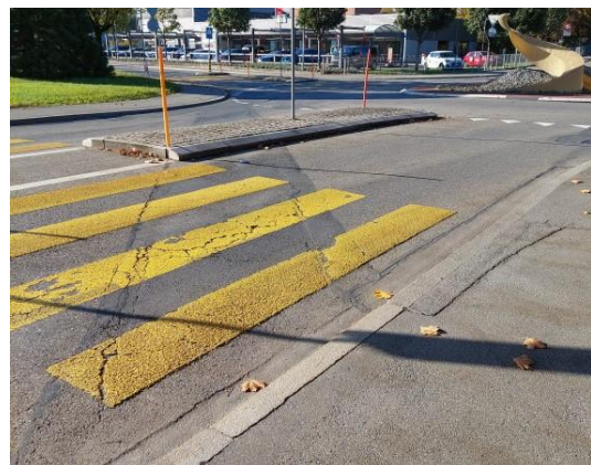
Abb. 9: Strukturelle Schäden und Flicke
