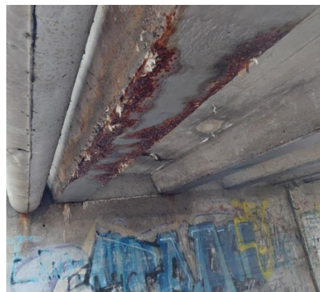
Abb. 11: Schäden an der Brückenplatte
