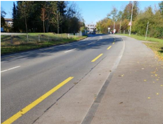
Abb. 4: Fehlendes westseitiges Trottoir
