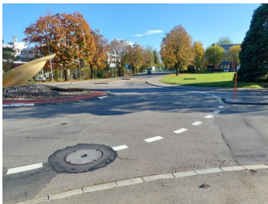
Abb. 8: Kreisels mit Belagsverformungen
